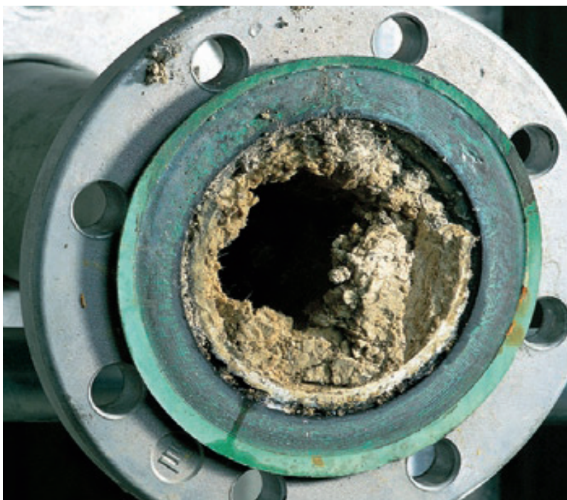
Fot. 4. Zwęźnienie przekroju rury kanalizacyjnej, źródło [8].
