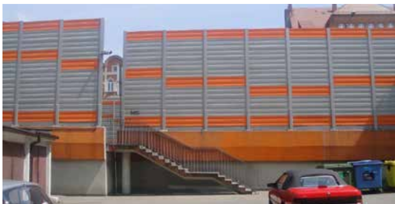
Fot. 2. Skuteczność ekranu niweczona jest przez otwór umożliwiający mieszkańcom wydostanie się z za ekranu na przystanek autobusowy (fot. autorzy).
