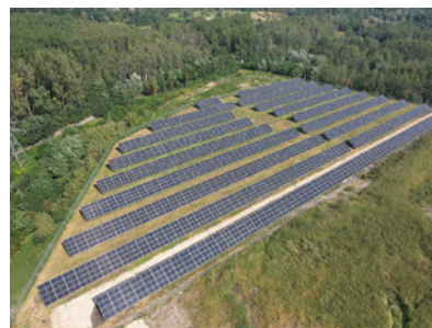
Fot. 5. Instalacja fotowoltaiczna na nieczynnej kwaterze składowiska odpadów (autor: KAW)
