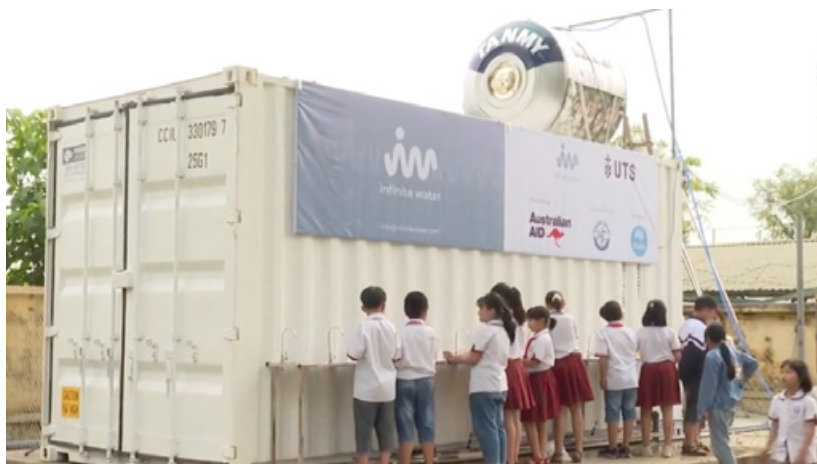
Fot. 6. Kontenerowe urządzenie do uzdatniania wody gruntowej, która jest skażona zanieczyszczeniami (arsen, metale ciężkie) w Wietnamie
