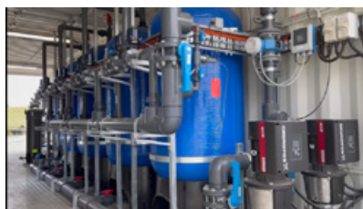
Fot. 2. Wnętrze kontenerowej instalacji uzdatniania wody gruntowej
