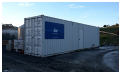
Fot. 1. Kontenerowa instalacja uzdatniania wody gruntowej, która pozwala uzyskać wodę nadającą się do picia
