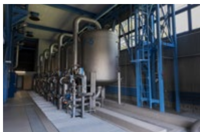
Stacja Uzdatniania Wody Leśna w Mikulczycach
