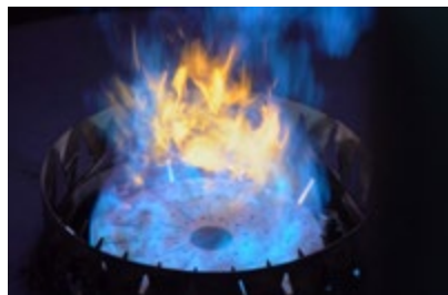
Fot. 1. Tak prezentuje się jeden z dwóch palników gazowego kotła podczas pracy. Palnik ma około... metra średnicy. Fot. MEC Koszalin
