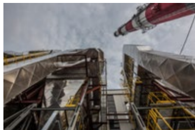
Fot. 3. System odpylania workowego z odsiarczaniem zapewnia oczyszczanie spalin pochodzących ze spalania węgla w 99,6 proc. Fot. MEC Koszalin
