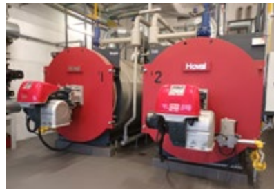
Fot. 1. Kotły gazowe z palnikami niskoemisyjnymi
