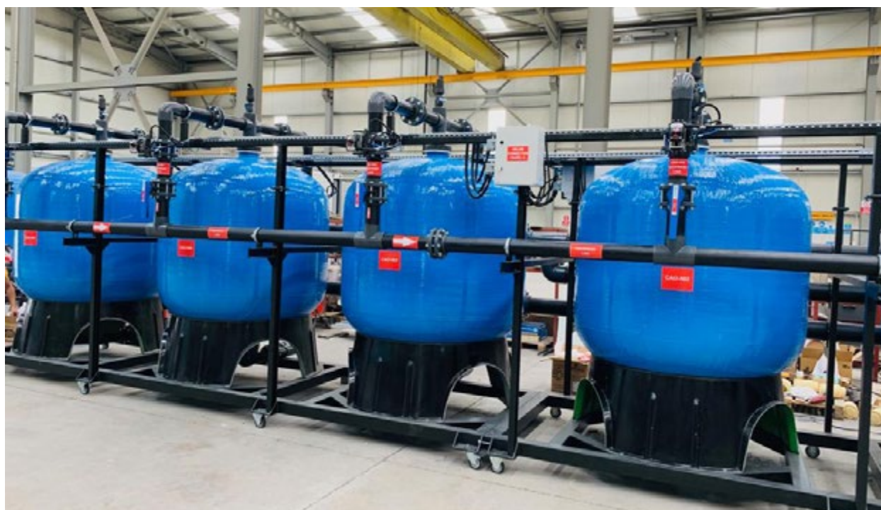
Fot. 2. Reaktory typu Hydroxon™ (filtry) do finalnego oczyszczania wody – dezynfekcja.
